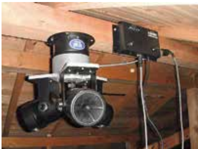
写真1：天井裏に設置した弾性振動波装置スーパーハヤブサ設置数・・・10mに1セットを目安にしてください。（1セット 回転式台、本体＋スピーカー3台）※100mの鶏舎であれば10セット必要になります。（100V電源が必要）
