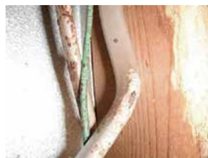
写真3 配線をかじった跡
