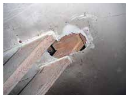
写真4 天井に続くネズミの通り道
